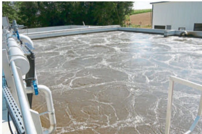
Die Verwirbelungen im neuen Schmutzwasserbecken zeigen, dass die Belüftungspumpen ihren Betrieb aufgenommen haben.
