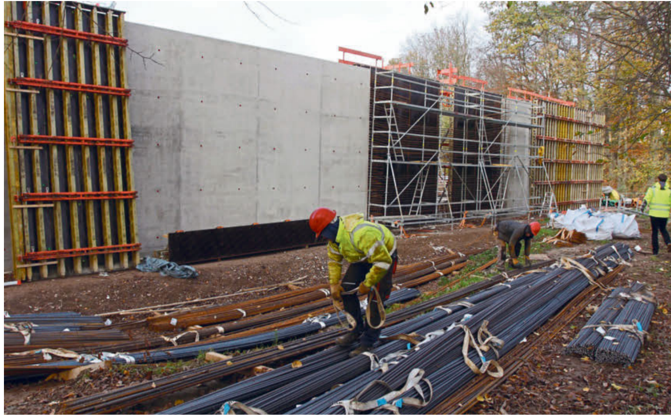
Tonnenweise Stahl wird als Bewehrung in den Beton eingearbeitet. Wenn das nicht ein paar Jahrzehnte hält?
