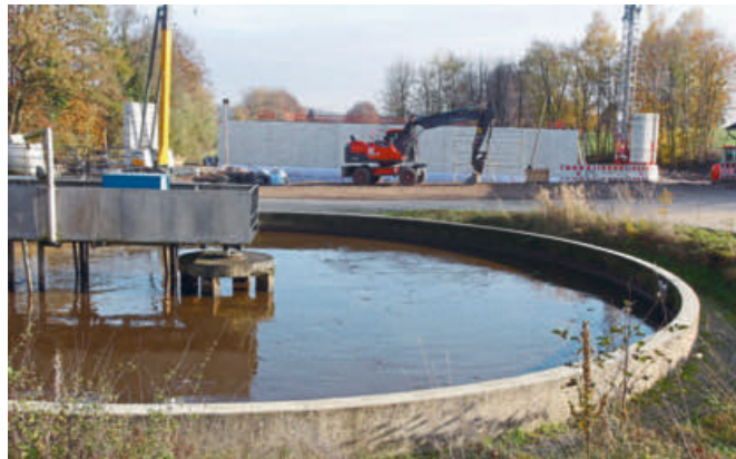
Das alte runde Belebungsbecken (im Vordergrund) bleibt erhalten, damit es bei einer technischen Störung als Puffer genutzt werden kann.
