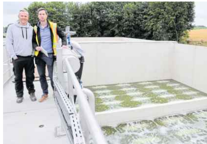
Guido Wemhöner, künftiger technischer Leiter der neuen Kläranlage, und Alexander Schweitzer vom Abwasserwerk vor dem Herzstück, der biologischen Reinigung. Noch ist sie nicht scharfgeschaltet, die ersten beiden der insgesamt acht Becken sind jedoch bereits teilweise befüllt. Im vollen Betrieb reicht der Wasserstand bis kurz unter die Betonlinie. Fassungsvermögen insgesamt: 8.000 Kubikmeter.
