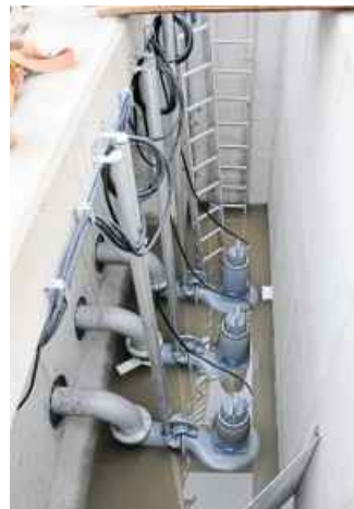
Drei Pumpen sorgen dafür, dass die Abwässer zur weiteren Klärung in den großen Becken landen. Im Fall eines Blackouts steht eine Notstromversorgung zur Verfügung.
